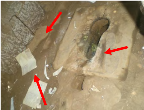
1: Latrine mal utilisée
